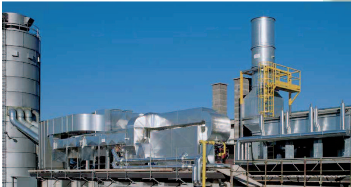
Impianto di abbattimento emissioni sov / VOC emission control plant
