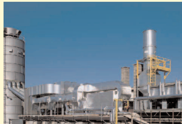
Impianto di abbattimento emissioni SOV con rigenerazione
