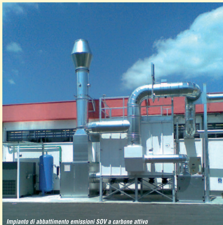
Impianto di abbattimento emissioni SOV a carbone attivo
